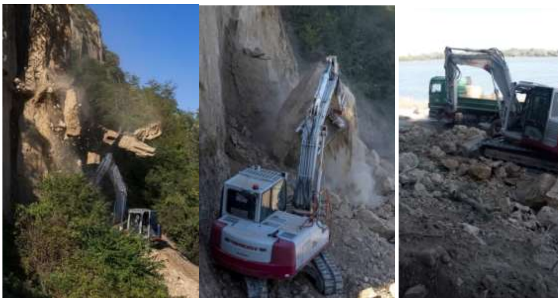
Слика 13. Контролисано обурвавање (рушење) лесног профила под називом „Зуб“
